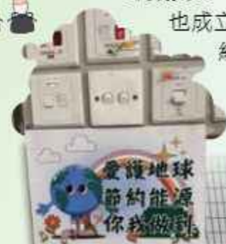
在課室窗燈開關上貼上「節約能源」的提示。
